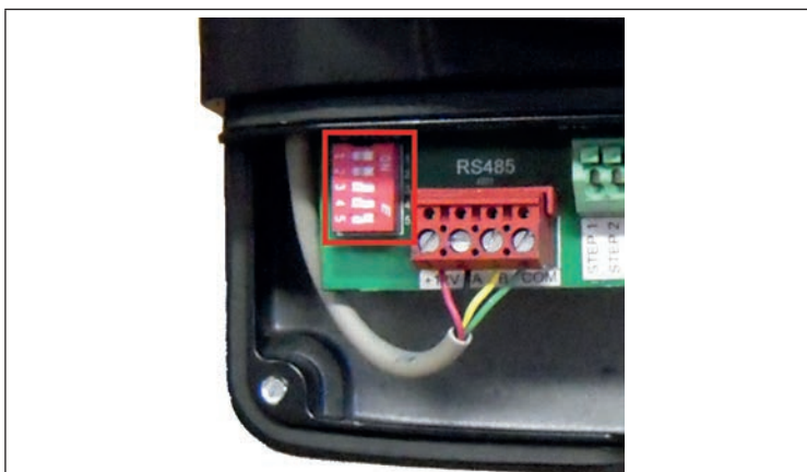
Position der Schalter zur Steuerung über iQPUMP
